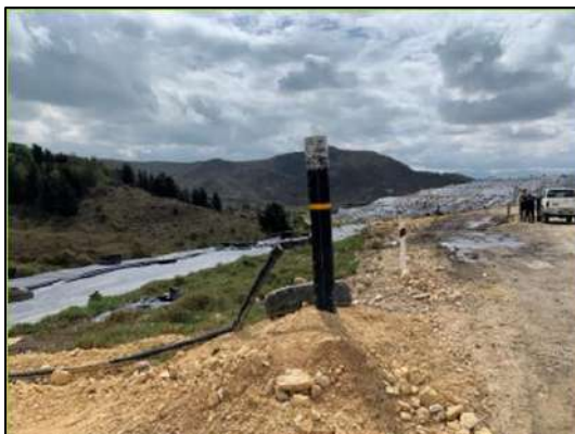
Foto 9. Sistema de captación de biogás
