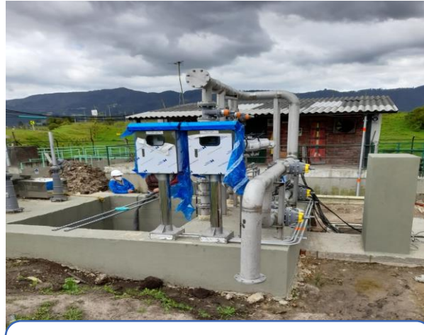
Estación de Bombeo
