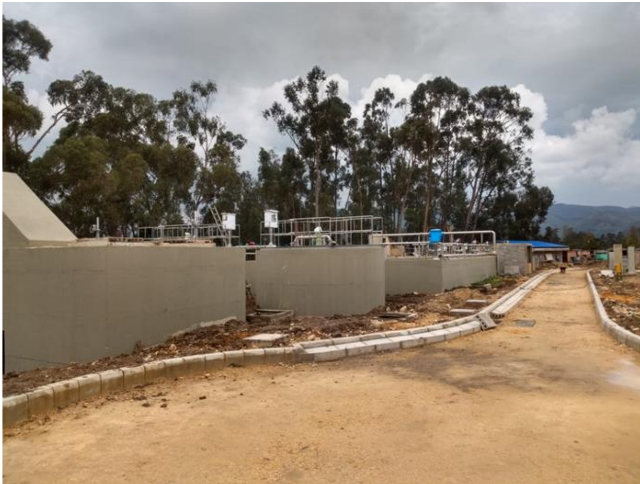
Interior acceso - tanques
