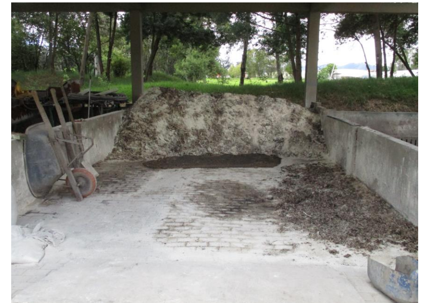
Lechos de secado con lodo residual
