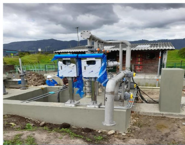
Estación de Bombeo
