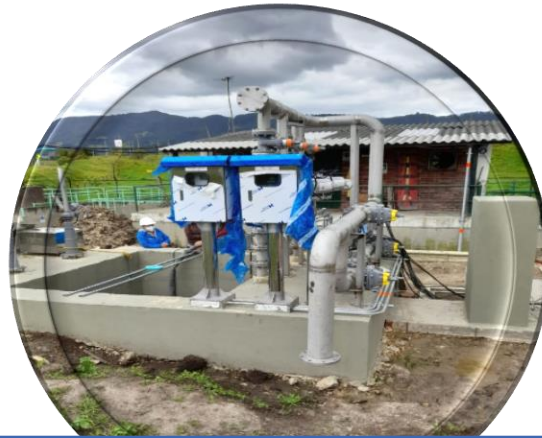
Estación de Bombeo
