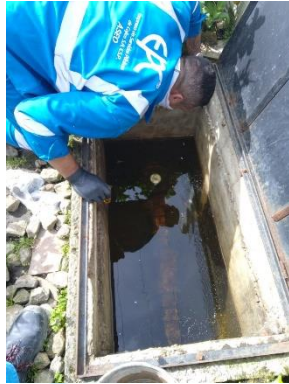
Figura 5. Revisión de baja presión, revisión del estado de la válvula del sector.
