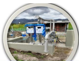
Estación de Bombeo
